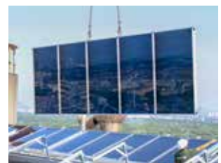
Projekt: Solarthermie-Anlage Wien
