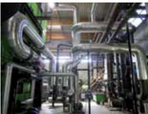
Projekt: Biomasse-Heizwerk Zeltweg
